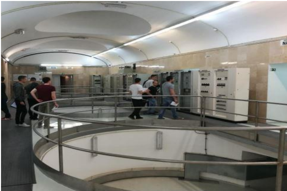
Slika 8: Komandno-zaščitni prostor, kjer imamo omare za krmiljenje elektrarne, vzbujalnike, zaščitne releje. V času konic je I1 malenkost večji od nazivnega I1n, da kompenziramo induktivnost zelo obremenjenih DV. Ponoči, ko so vodi kapacitivni, pa je tok I1 manjši od nazivnega I1n (primarna Q/U regulacija).
