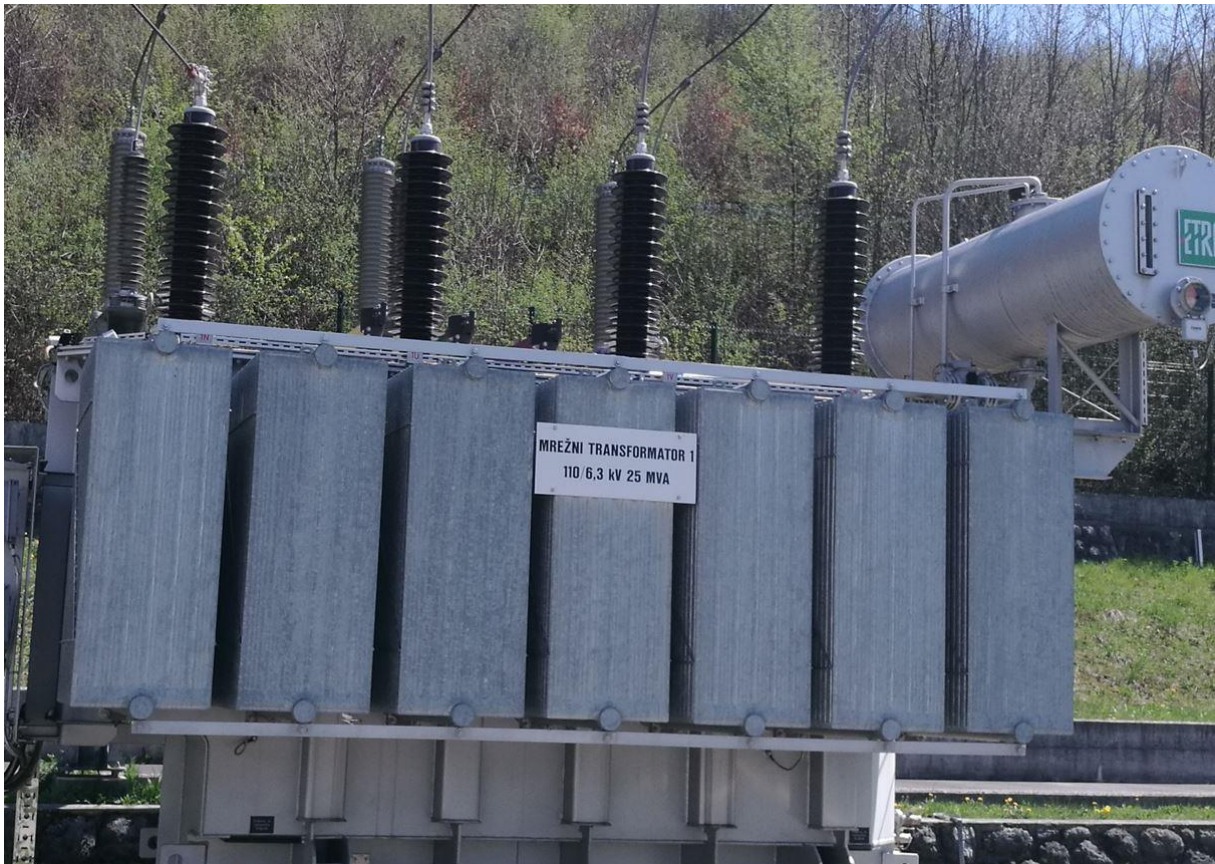
Slika 11: V RTP Moste imamo 4 energetske transformatorje. Dva (zaradi redundance oz. n-1 kriterija) sta blok transformatorja, ki dvigneta napetost generatorjev 6,3 kV na 110 kV mrežo. Dva pa sta mrežna TR, ki spustita 110 kV napetost na SN nivo 20 kV. Te SN moči distributer vodi do okoliških krajev in podjetij. Transformatorji imajo moči 25 MVA in vezno skupino YNyn0. TR 110/ 20 kV sta regulacijska, saj z 8 odcepi navzgor in 8 odcepi navzdol lahko reguliramo primarno in s tem tudi sekundarno napetost 20 kV omrežja.
