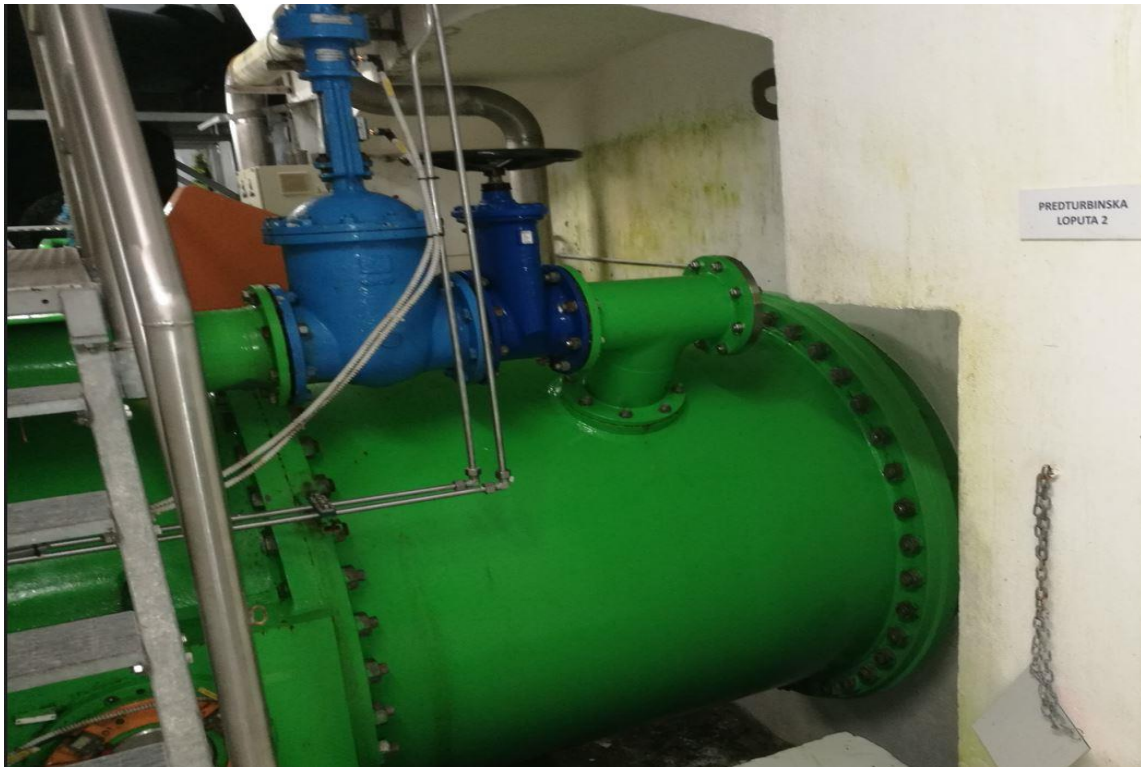
Slika 6: Predturbinska loputa je delovna loputa, s katero vsaj dvakrat na dan zaprejo vodo v turbino. Zasun zgoraj pa je loputa, ki se uporaba samo zasilno. Nahaja se v turbinski etaži.
