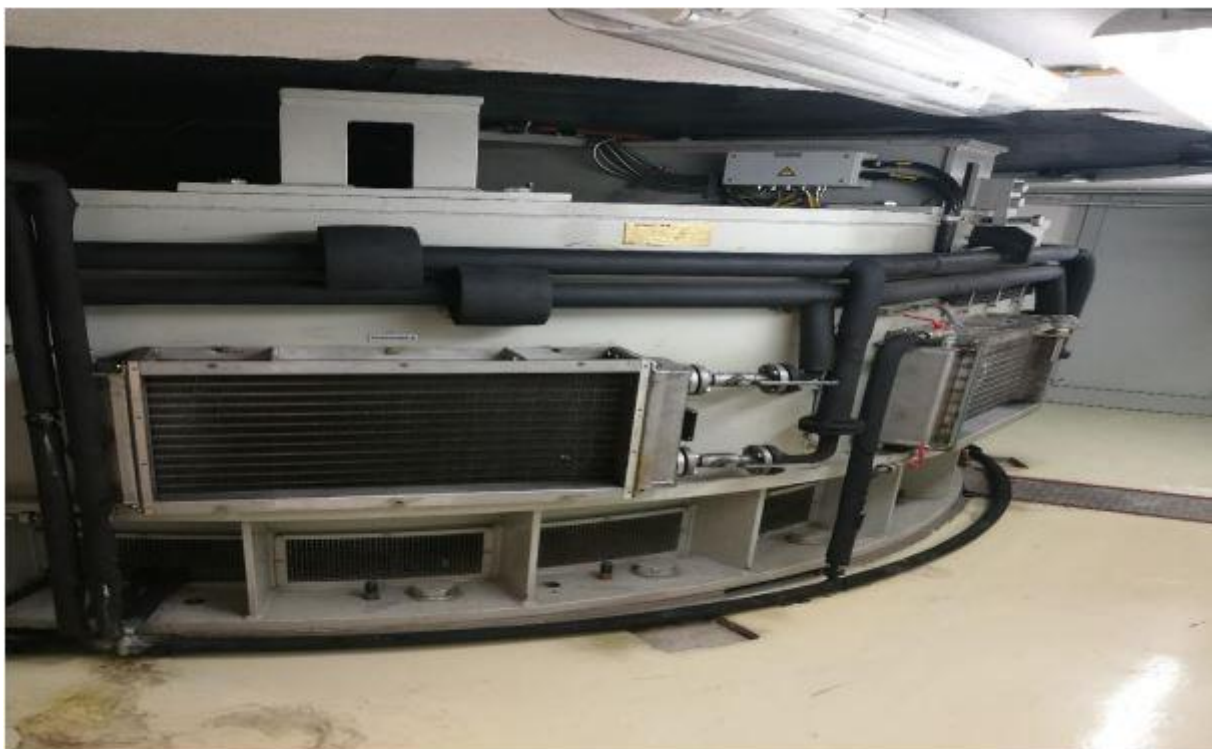
Slika 7: Generatorska etaža, vodno hlajenje statorja 3-f SG (hidrogeneratorja). Hidrogenerator ima velik radij, veliko polovih čevljev na rotorju in kratek rotor ter majhno moč, tale ima 7,5 MVA. Statorski tokovi so dobrih 1.000 A
