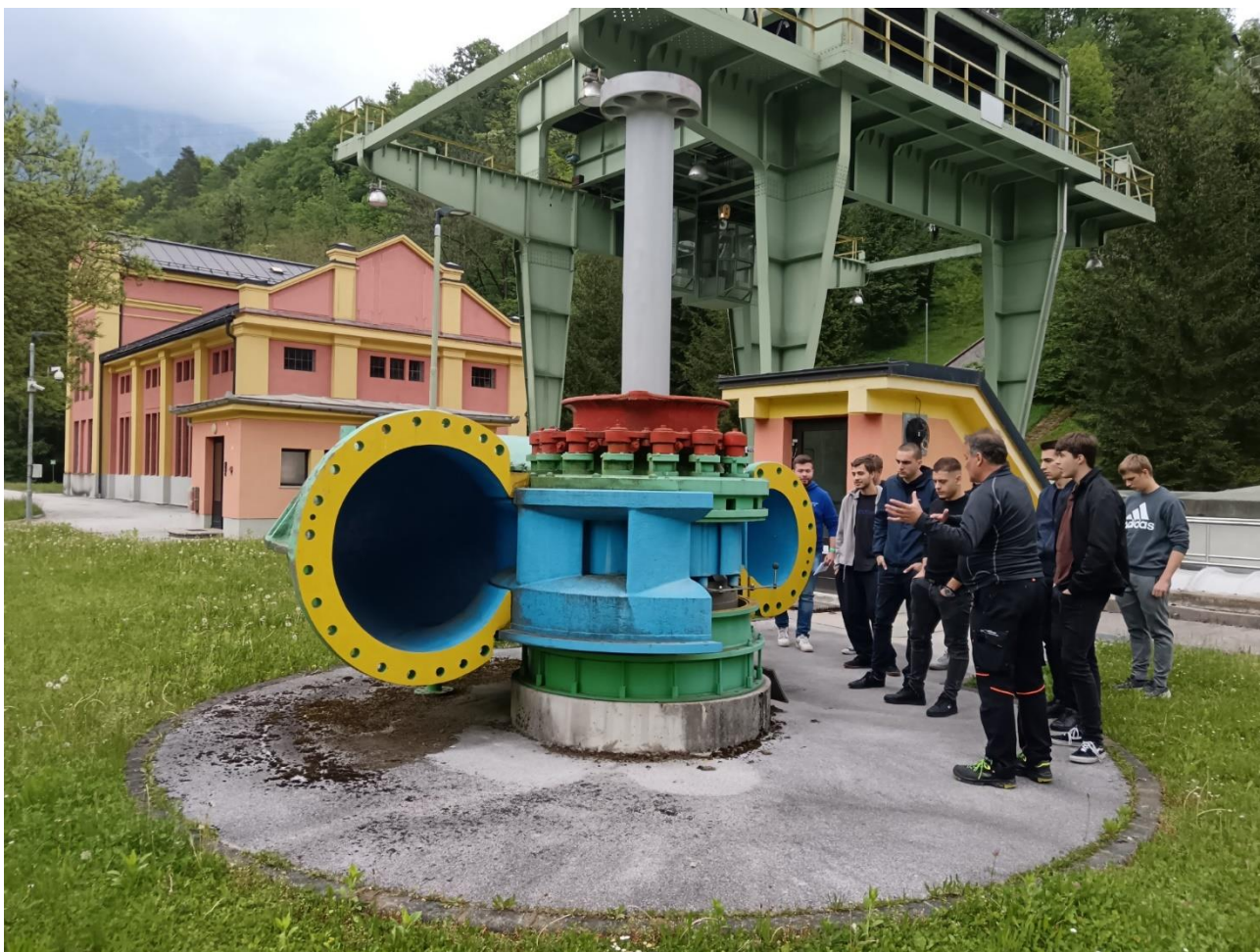
Slika 2: Francisova VT turbina svetlo modre barve, značilen polž rumene barve, ki vodi vodo iz cevovoda na lopatice turbine. Levo zadaj rdeča stavba muzeja HE, zadaj zeleno mostno dvigalo za dviganje agregata in betonskih pokrovov v 4 agregatnih jaških
