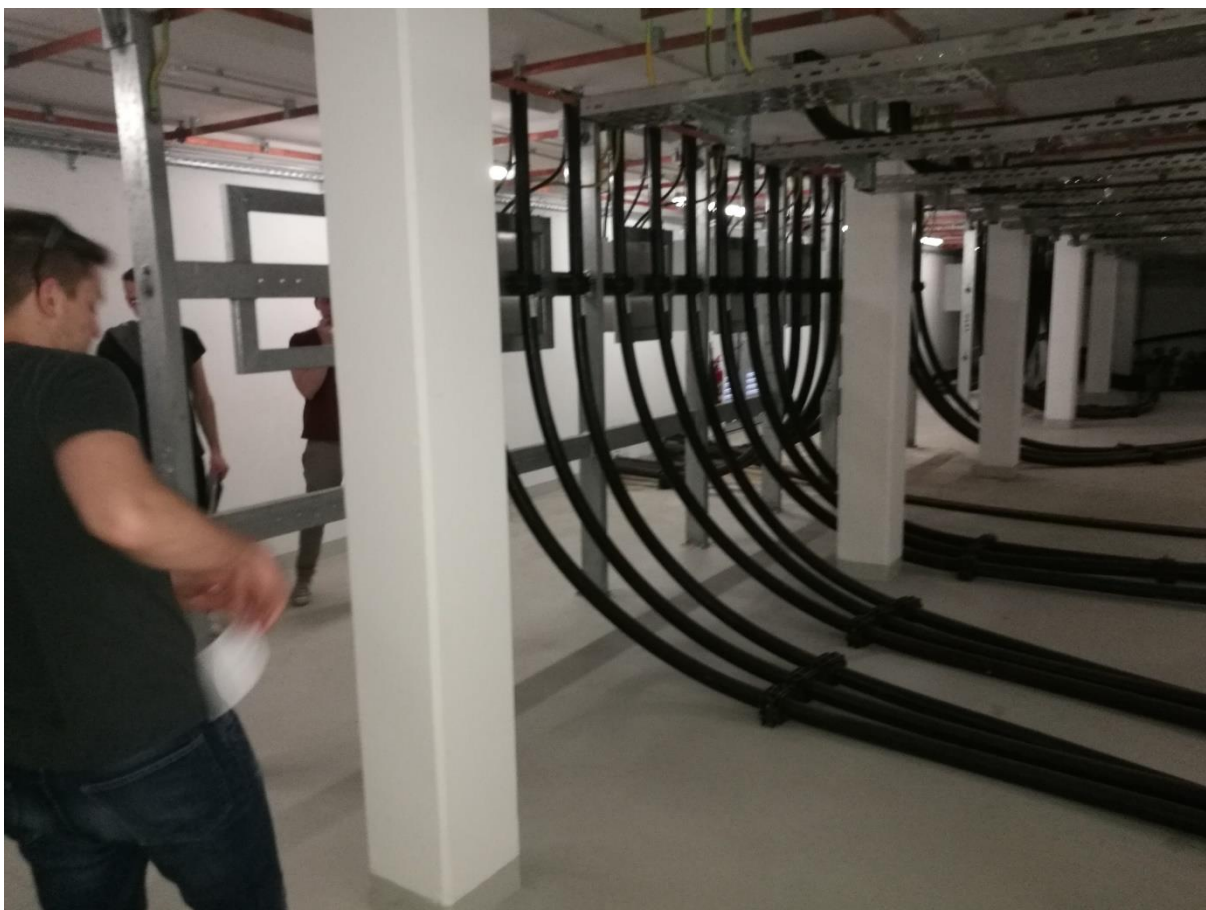
Slika 18: V kleti RTP objekta je kabelski prostor s skobami, ki pritrjujejo kable. Najdebelejši so 1-žilni VN kabli 110 kV, manj izolacije imajo so 1-žilni kabli 20 kV in nato 1-žilni kabli 6,3 kV.
