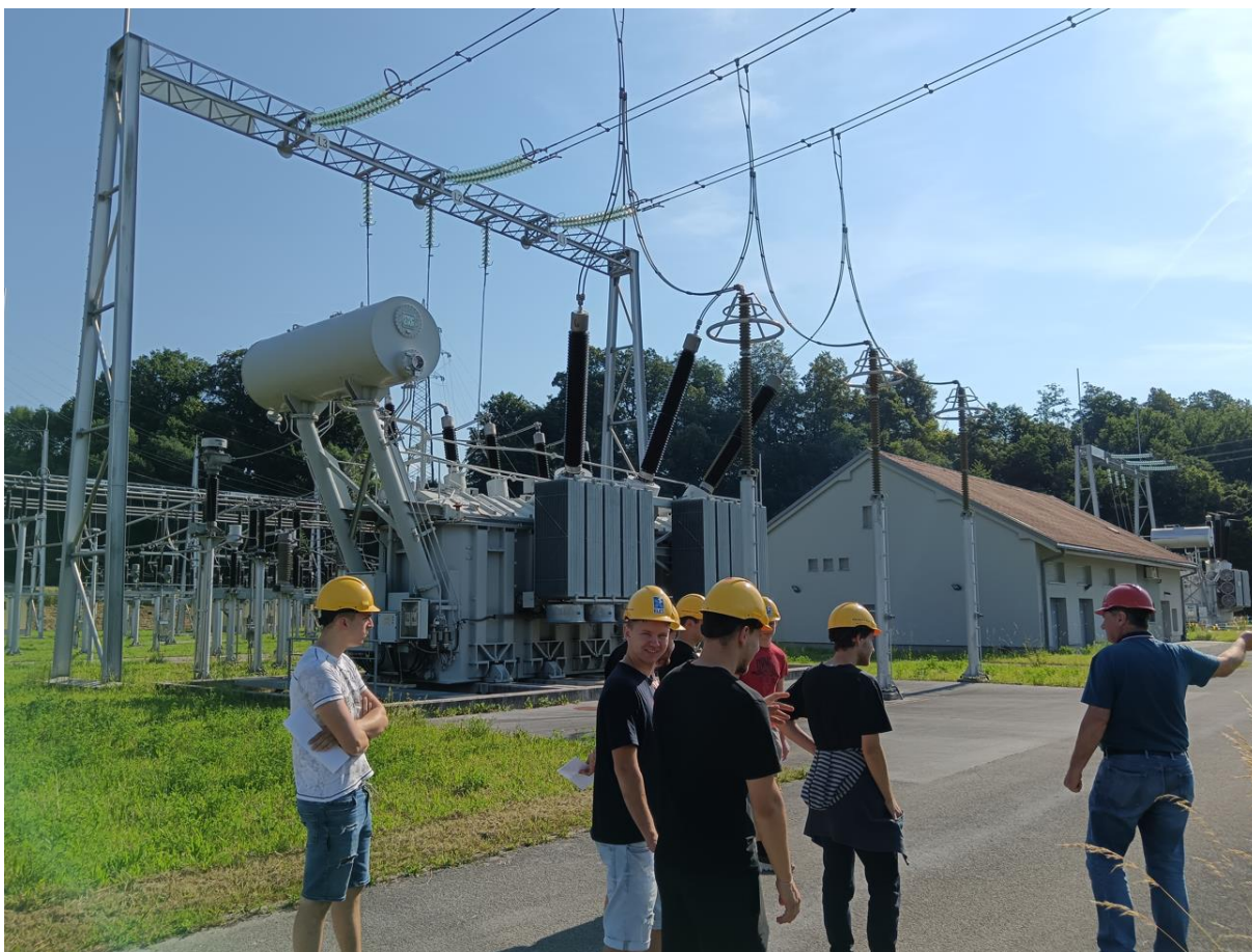
Slika 2: 300 MVA energetski TR 400kV/110 kV, YNyn0d5 vezne skupine. Spredaj so trije prenapetostni odvodniki, ki ga ščitijo pred strelo (prenapetostjo), zgoraj konstrukcija portala, na katerega so pripete z zateznimi izolatorskimi verigami zbiralke TR polja
