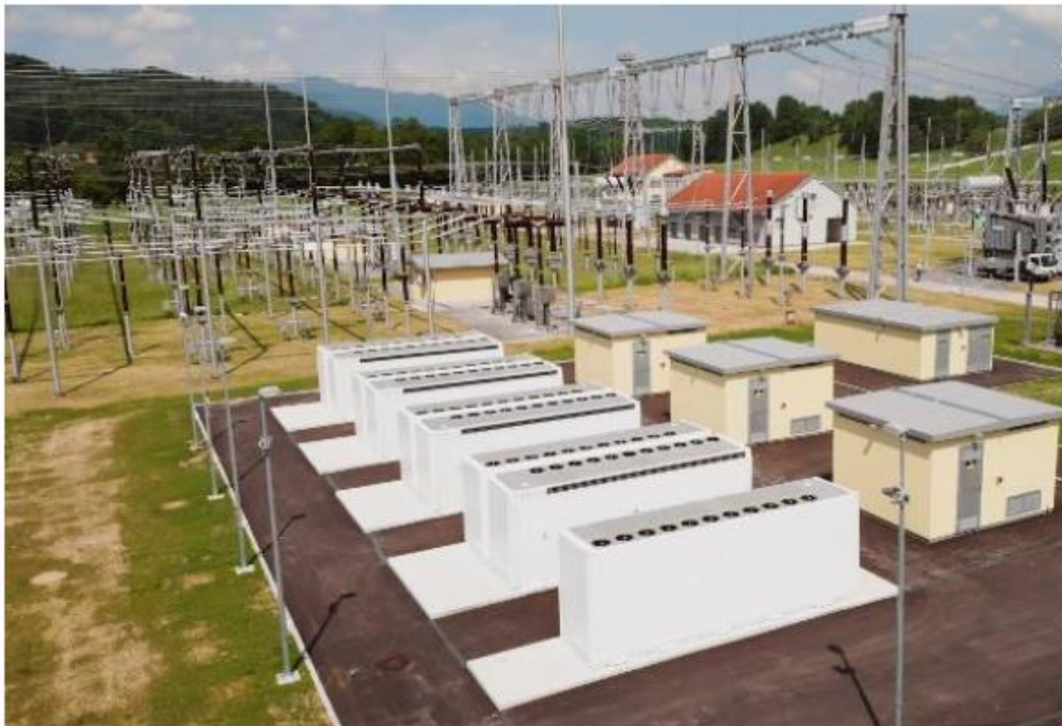
Slika 4: Pogled na RTP Okroglo iz strani novega baterijskega 110 kV stikalnega polja (9 Megapack Tesla kontejnerjev spredaj levo – bele barve, prvi je sam na temelju, ostali so v 3 dvojicah na betonskem temelju, tri rumene distribucijske TP 20/0,48 kV, desna rumena hiška je 20 kV stikalni blok iz TR in kabelskih vodnih celic, pod zemljo so 20 kV kabli. Še bolj desno pa stoji in se na fotografiji ne vidi 110 /20 kV ETR, ki napaja baterijski sistem preko SN stikališča in 3 DTP (vir ELES)
