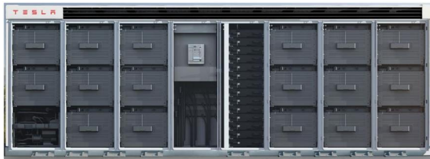
Slika 3: Tesla Megapack iz litij-ionskih malih baterij, ki jih nadzira baterijski krmilnik BMS, katerega glavna enota je razsmernik. BMS omogoča sodobno regulacijo P/f (primarno, sekundarno) in U/f. (vir ELES)
